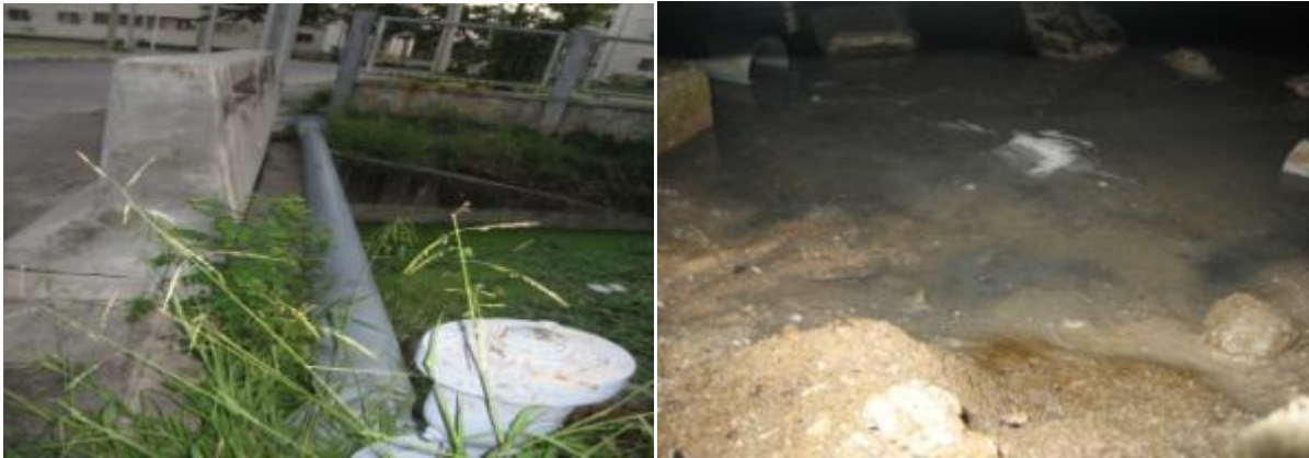
รูปที่ 2. 13 น้ำขังในบริเวณแหล่งที่ปัก
